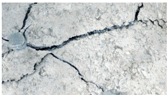
Spalten durch Quelldruck
